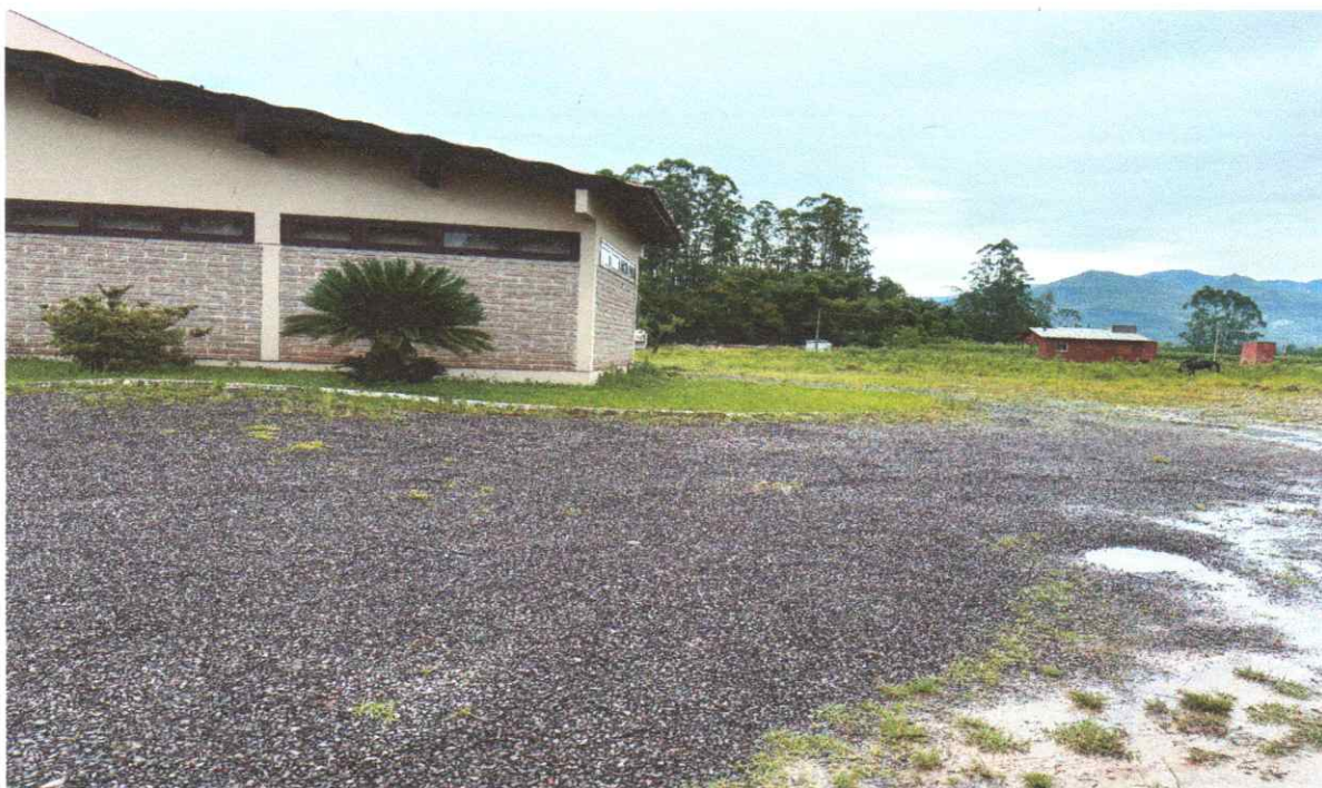
3: fotografia demonstrando ausência de passeio para acesso à garagem do prédio
